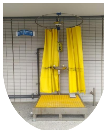
水處理區緊急沖淋設備
